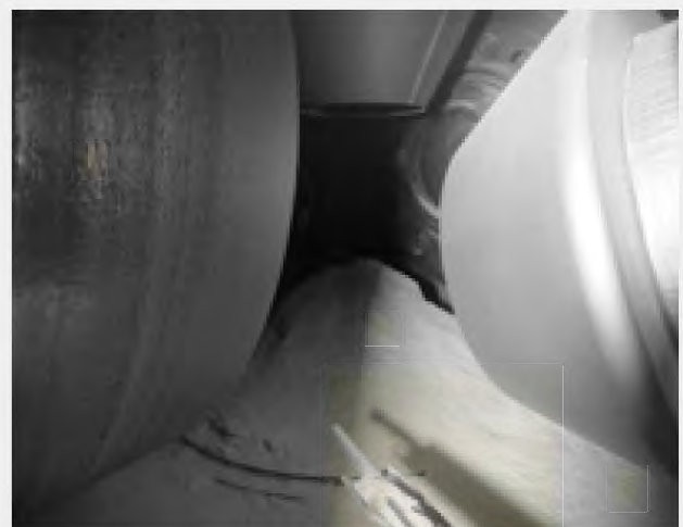
Intérieur du broyeur à Fos-sur-Mer
